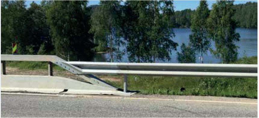
Vegkant; Ensidig overgang VG-W rekkverk
